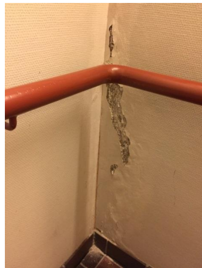
Fuktgjennomslag i kjellerrom. Foto: Antonia Reime Aabø.
