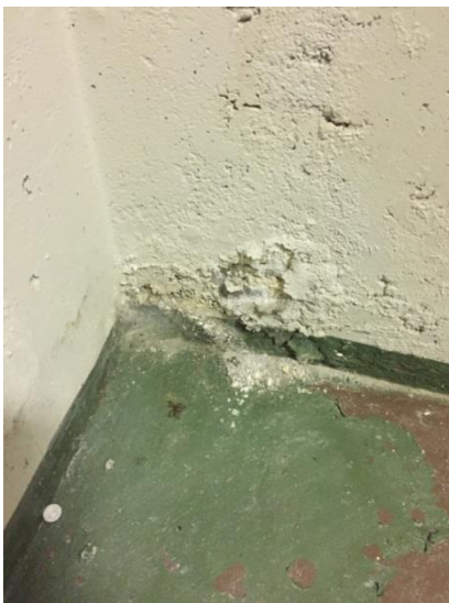
Arkivlokale med saltutslag og flassende maling. Foto Antonia Reime Aabø.
